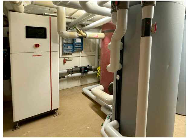
Wärmepumpe im verbauten Zustand
